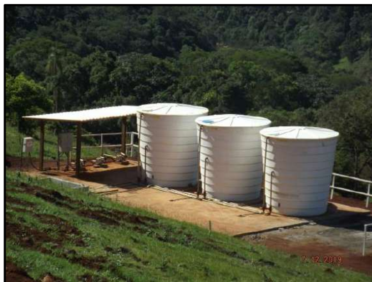
Figura 55 – Instalações definitivas da estação de tratamento de efluentes.
