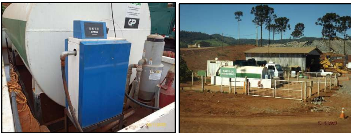
Figura 45 – Tanque aéreo de combustível.
