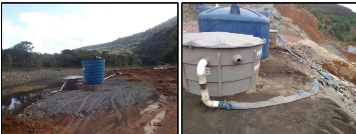
Figura 72 – Sistemas de tratamento de águas de empoçamento provenientes de frentes de escavação do túnel de adução.
