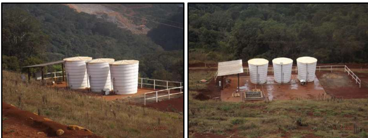
Figura 62 – Estruturas da estação de tratamento de efluentes.
