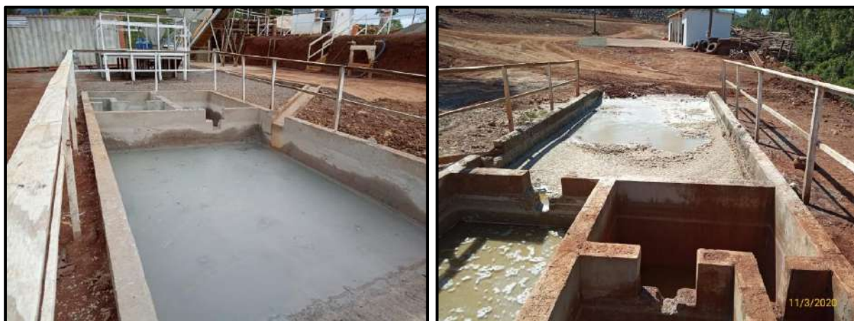
Figura 67 – Estrutura de bate-lastro para limpeza de caminhões betoneira.
