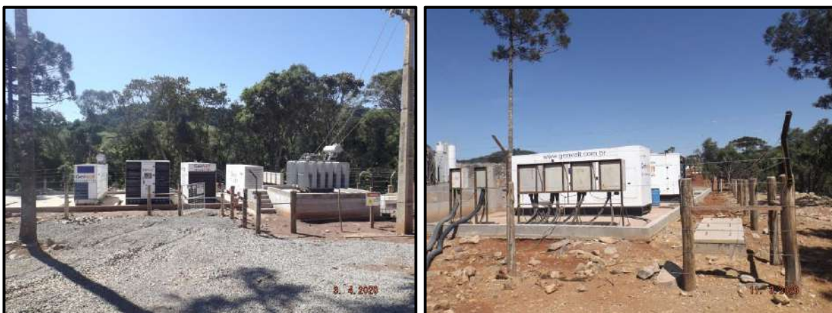
Figura 73 – Central de geradores instalada.
