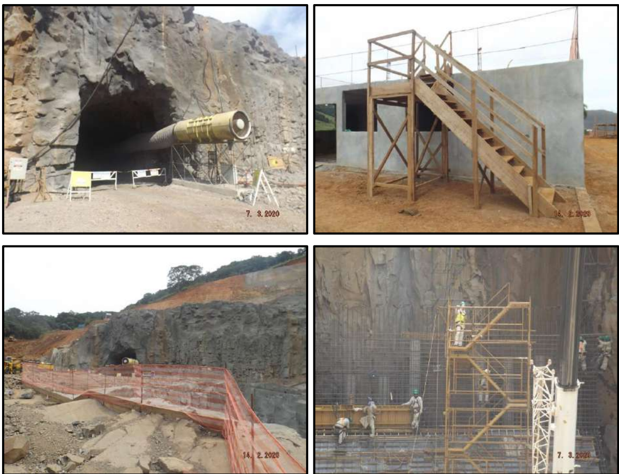
Figura 105 – Instalação de barreiras / dispositivos de segurança aos trabalhadores, como ventiladores para túneis, guarda-corpos e andaimes.
