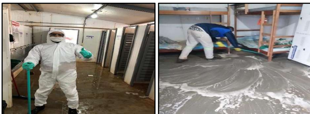
Figura 117 – Ações de higienização em alojamentos e demais estruturas do canteiro de obras.
