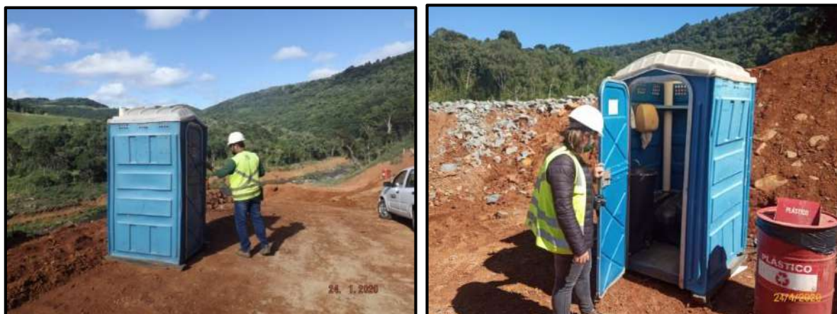
Figura 52 – Inspeções de banheiros químicos instalados nas frentes de obra.
