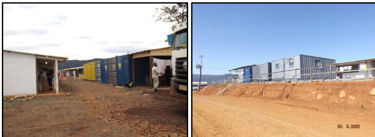
Figura 116 – Instalação de containers dormitórios para aumento da capacidade de alojamento no canteiro de obras após medidas de isolamento social.
