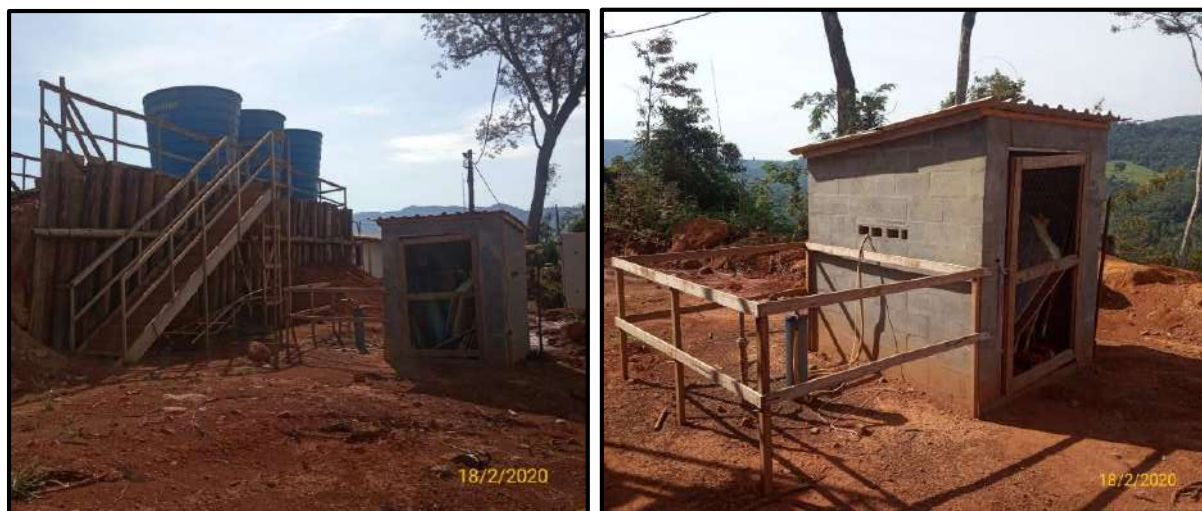
Figura 69 – Captação de água em poço artesiano e desinfecção com bomba dosadora de cloro.
