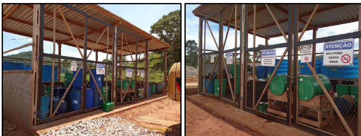
Figura 31 – Central de armazenamento de produtos perigosos.
